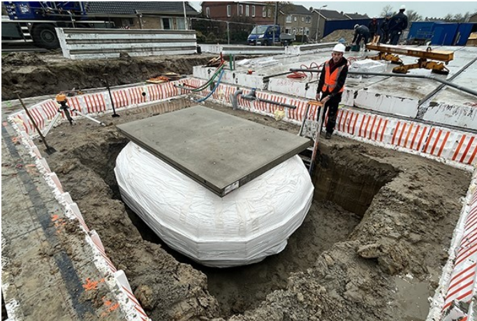
Plaatsen grond accu (warmte)
